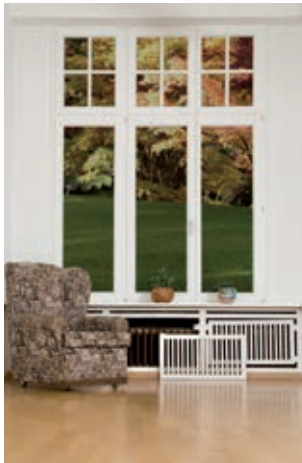
Vorher: herkömmlicher Heizkörper
